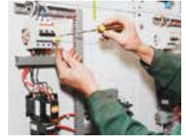
Electrician عامل الكهرباء
